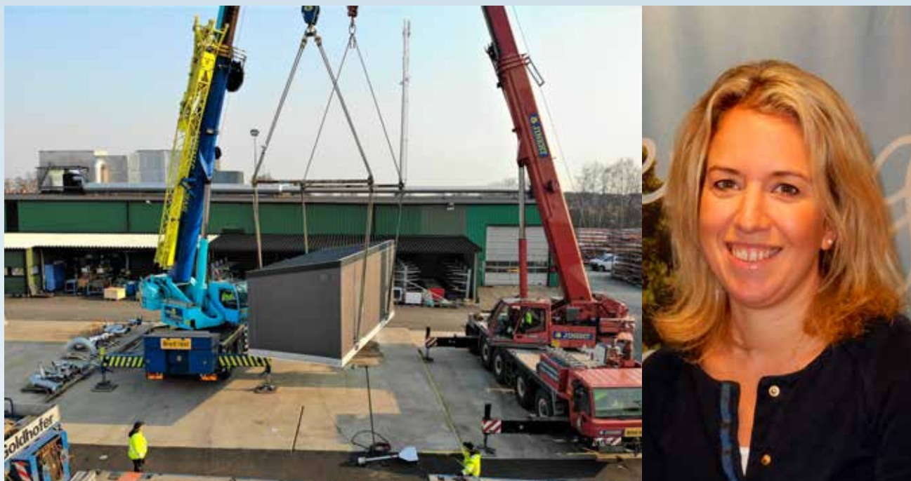
Malmberg bygger energicentralen Energeo i sin verkstad och levererar den som ett nyckelfärdigt teknikhus, berättar Marie Löfdahl på Malmberg Geoenergi.
