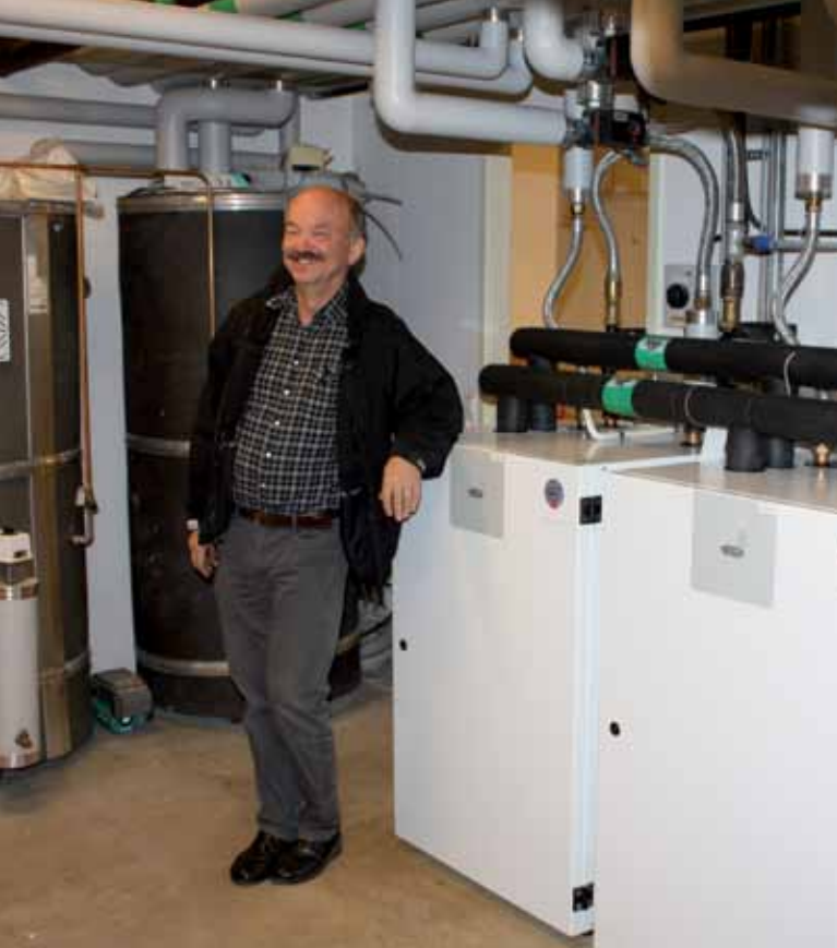
Tre pumpar i källaren på Hälsans hus i Åseda tar värme och kyla ur berget och halverar energikostnaden, berättar Ewald Strandberg stolt.
