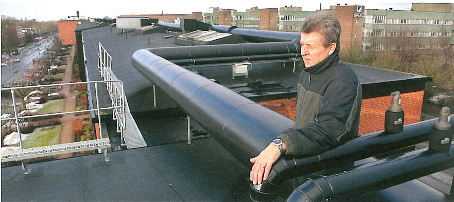
Vicevärd Anders Henriksson vid den nybyggda ventilationen, som är en del av Tunahus geoenergilösning.
