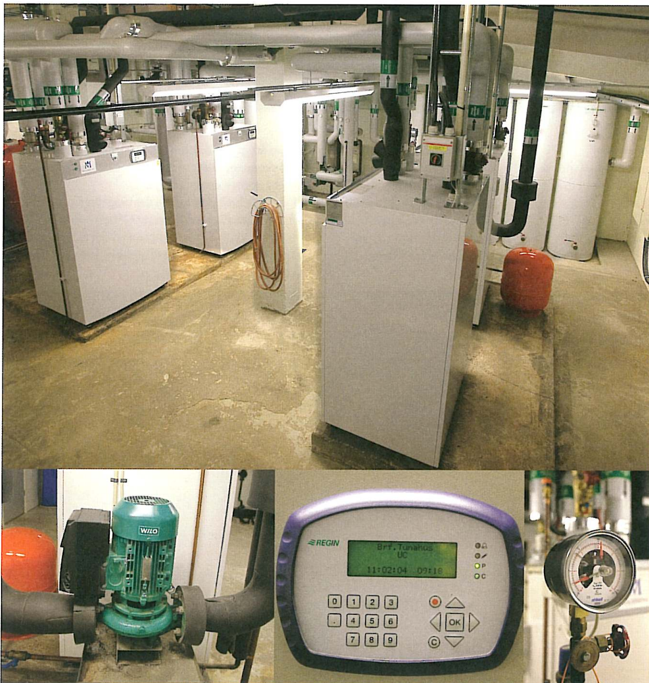
Den del av geoenergianläggningen som finns ovan jord har placerats i föreningens gamla pannrum, där det ursprungligen eldades med de boendes egna sopor.
